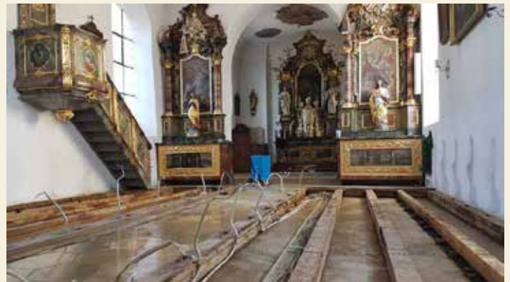
Die Schäden in der Pfarrkirche St. Richard in Otting. pde-Foto: Johannes Heim
